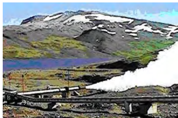
Figura 5: Pozo COP-4 y vaporducto (volcán Copahue) .
