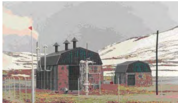
Figura 3: Planta geotérmica instalada en COP-1.
