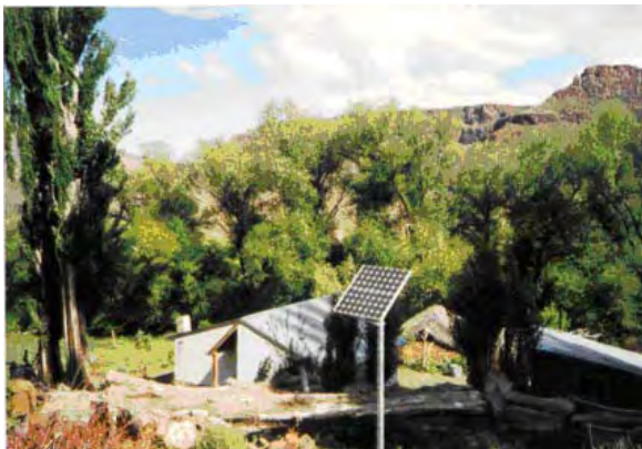
Figura 2: Instalación fotovoltaica en vivienda Paraje Reñileuvú.
