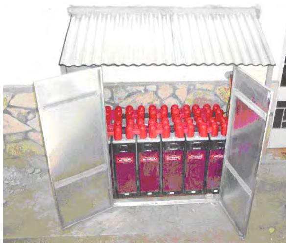
Figura 4: Banco de baterías en escuela
