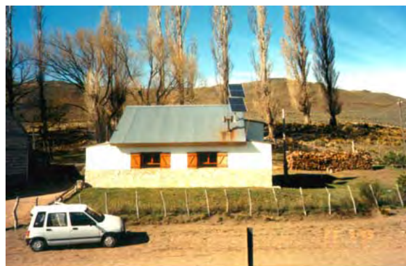
Figura 5: Instalación fotovoltaica en Puesto Sanitario – Paraje San Ignacio
