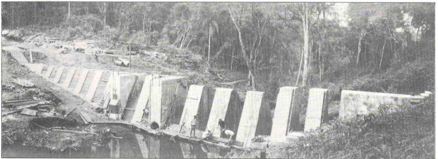
Construcción de un dique en el pueblo de Salto Pereyra, Misiones, Argentina.
