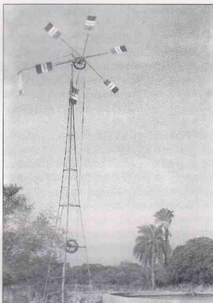
Aerobomba de Mecate modelo 270 con rotor de 3,6 m., pozo de 10 m con pila de 60 m 3 para regadío, instalado en Santa Rita, Nicaragua.
