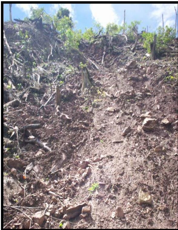
Fotografía N°.12. Deslizamiento de tierras en altas Pendientes en Nuevo Piura.
