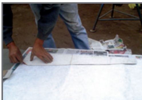
Foto N° 21: Procedimiento de corte de capas de fibra de vidrio usando plantilla. Fuente: Soluciones Prácticas – ITDG.
