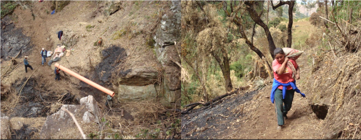
Beneficiarios del proyecto apoyando de los trabajos para la construcción de la MCH
