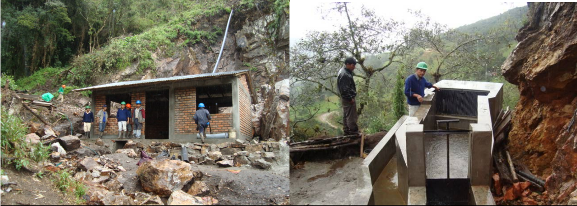
Casa de máquinas, desarenador y cámara de carga de la MCH del Chorro Blanco
