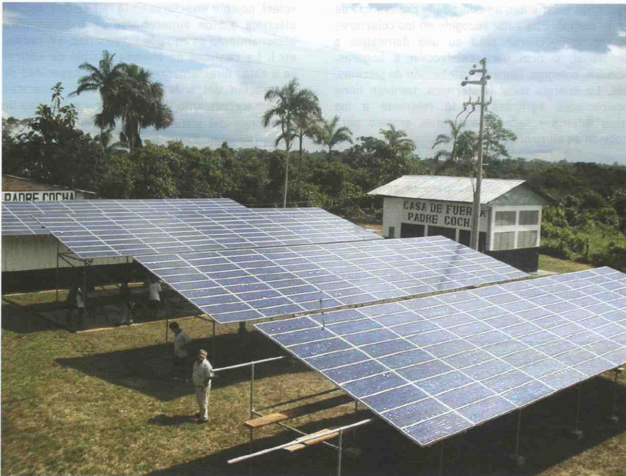
Sistema Híbrido (Fotovoltaico - Grupo Térmico) - Padre Cocha, Iquitos
