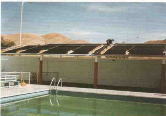
Piscina temperada mediante termas solares- Cujajone - Moquegua
