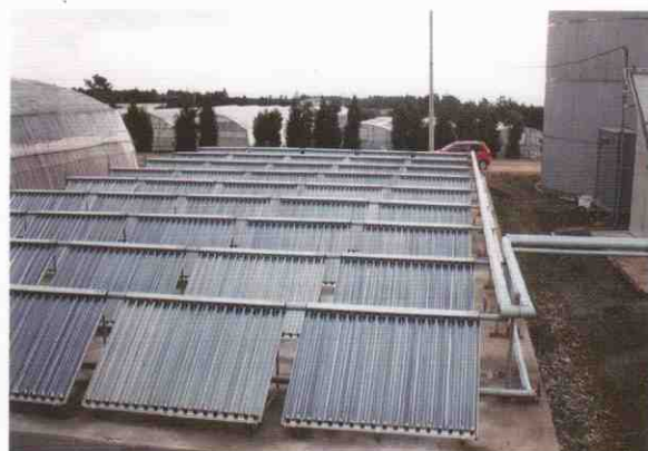
Termas Solares que emplean tubos al vacío - Corea del Sur
