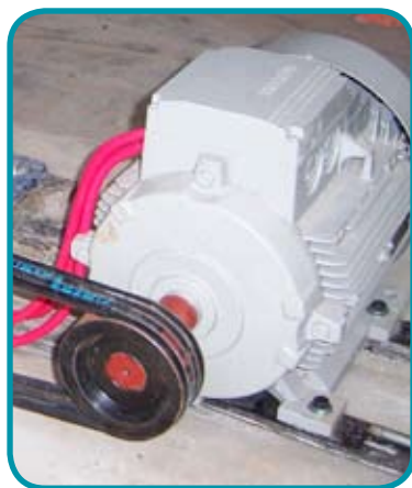
GENERADOR DE INDUCCIÓN
